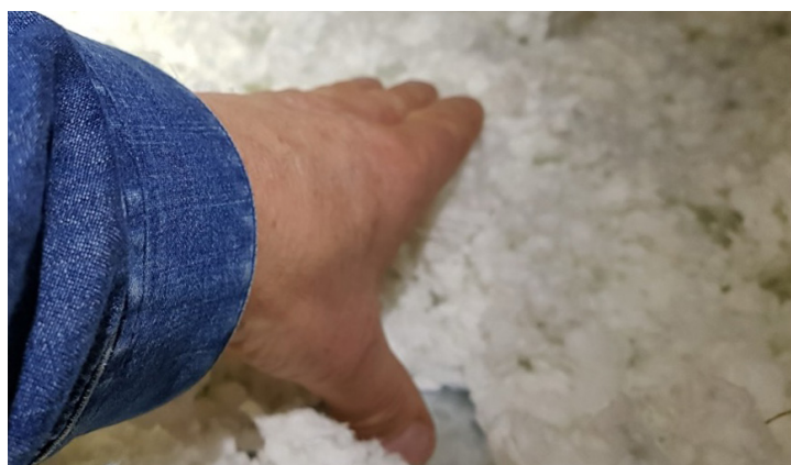
Bild: Bristfällig drevning kring fönster. Bild 1 nedan: Ej isolerade frånluftskanaler Bild 2 nedan: Fuktskydd av konstruktioner Foto: Lars Tobin
